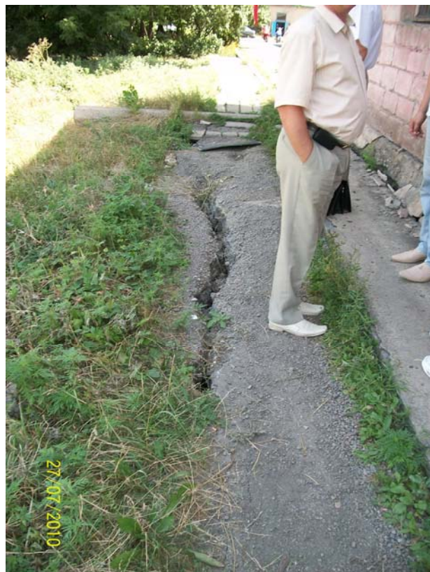
Рис. 8. Трещины по границе мульды оседания
