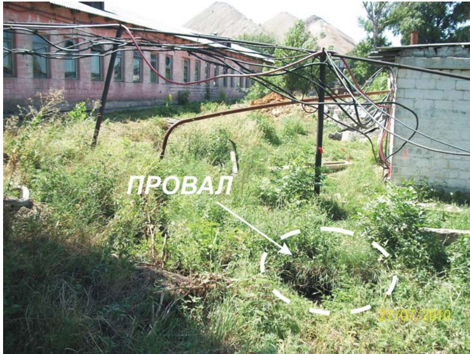
Рис. 7. Место образования провала на промплощадке шахты
