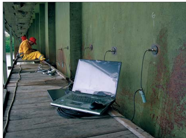
Рис. 4. АЕ-діагностування секції металевої несівної балки моста через р. Дністер
