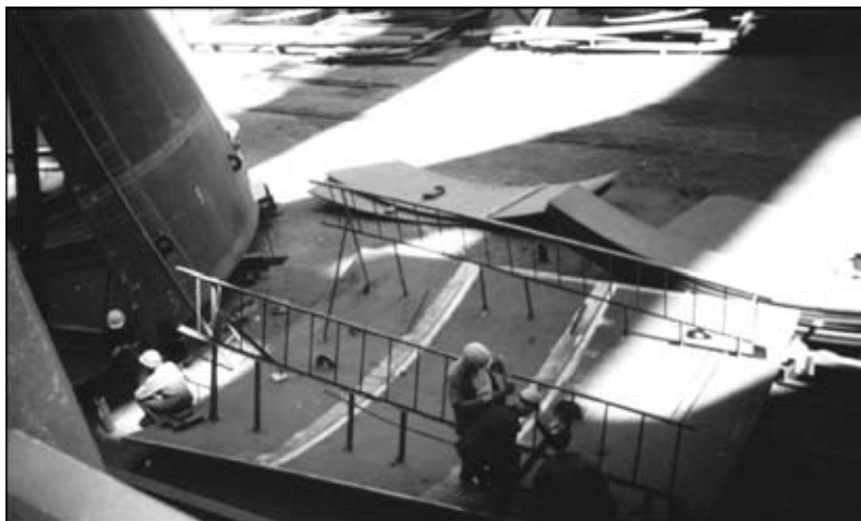
Рис. 1. Подготовка сваренных ЭШС блоков к контрольной сборке царги корпуса ДП-9 КГМК «Криворожсталь»
