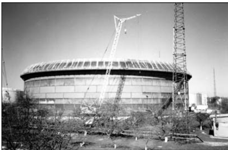
Рис. 2. Резервуар вместимостью 75000 м 3 с применением стального проката 06Г2Б класса прочности С440 г. Броды (строительство осуществлялось методом подрачивания)
