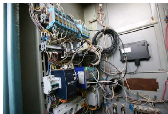
Рис. 3. Оборудование КТС, расположенное в шкафу стенда
