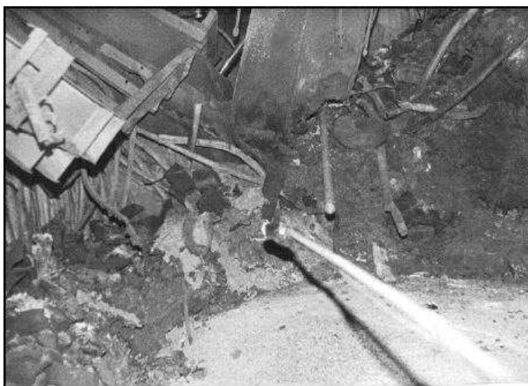
Рис. 6. Южная зона проплавления ФП (помещение 305/2).
