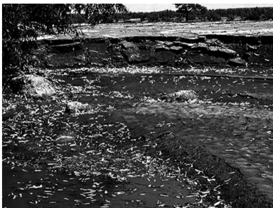
Рис. 3. Плотина-отстойник, к северо-западу от Севильи после разрушения.
