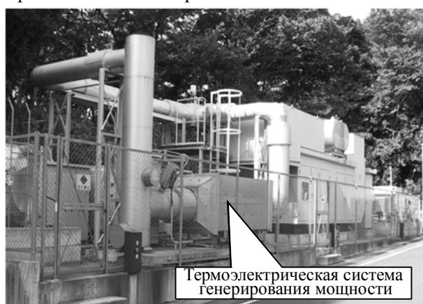
Рис. 1. Демонстрационная испытательная установка мощностью 1 кВт, установленная в системе совместного генерирования тепла и электричества от дизельного двигателя 500 кВт.
