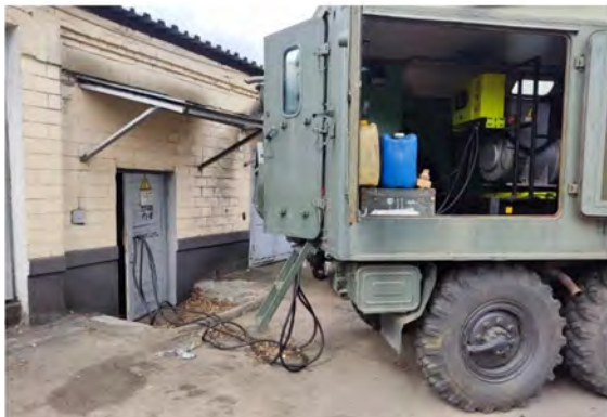
Фото 8. Генератор, наданий хлібокомбінату обласною військовою адміністрацією 17 .
