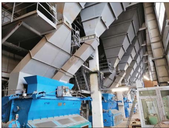
Рис. 3. Котли «Радіант» Хоростківського цукрового заводу, переобладнані на спалювання пелет з рослинної біомаси та/або газового вугілля
