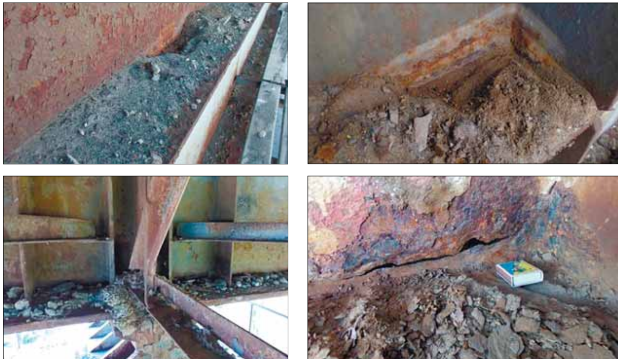
Рис. 2. Сміття на головних балках і корозійні пошкодження мосту ім. Є.О. Патона
