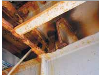
Корозія та руйнування вузлів кріплення стовпів освітлення
