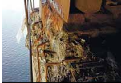
Часткове руйнування бетону ригеля опори № 11 під підферменником
