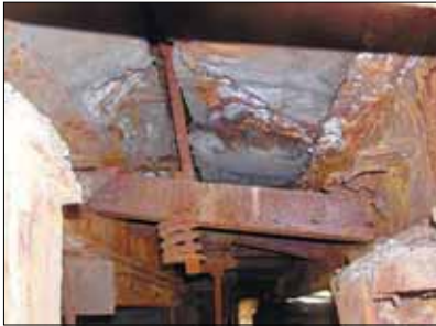
Корозія та руйнування елементів деформаційних швів і прилеглих поперечних балок
