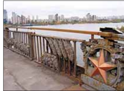
Руйнування секції перильного огородження та їх кріплень
