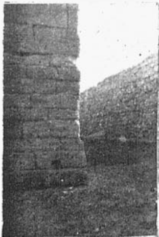
Рис. 85. Поврежденный угол 1 яруса кладки 19 куртины. Вдали протейхизма.
