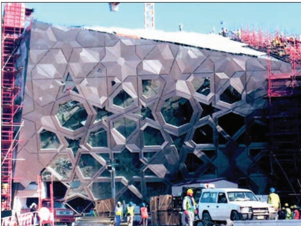
Рис. 10. Облицовочные титановые панели
