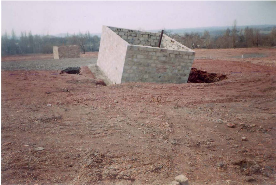
Рис. 2. Провал на устье ликвидированного наклонного шурфа
