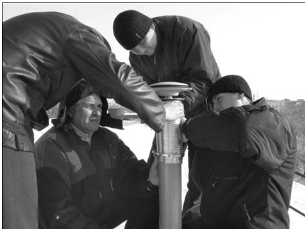
Рис. 4. Розгортання перманентної GPS/GNSS-станції PRYL (м. Прилуки)
