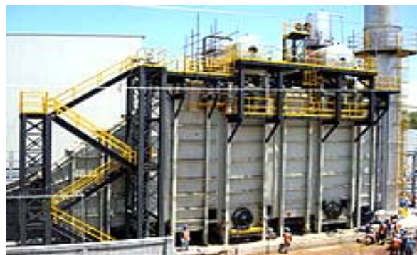
Рис. 2. Общий вид теплоутилизационного котла ГТЭС [7]
