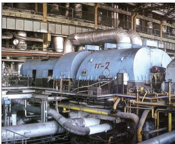
Рис. 1. Общий вид турбины ПТ-200-130
