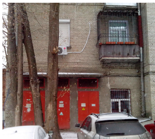
Рис. 1. Типичный жилой дом со встроенной ТП (г Харьков, ул. Данилевского, 19)
