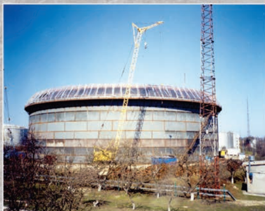
Резервуар для хранения нефти объемом 75000 м 3 из стального проката 06Г2Б-440
