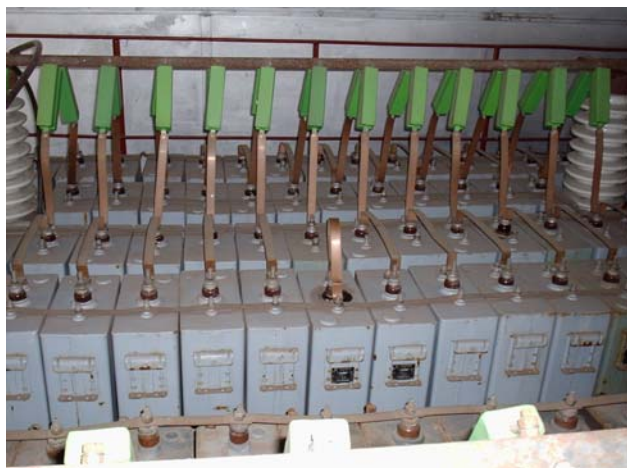
Рис. 10. Общий вид третьего этажа мощного ЕНЭ на \pm 5 кВ, медной ошиновки и защитных керамических резисторов типа ТВО-60-100 Ом разрядной цепи имитатора – C
