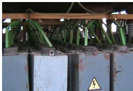
Рис. 8. Общий вид высоковольтных элементов мощного C –накопителя отечественного ГИТ-100 с запасаемой энергией в 840 кДж
