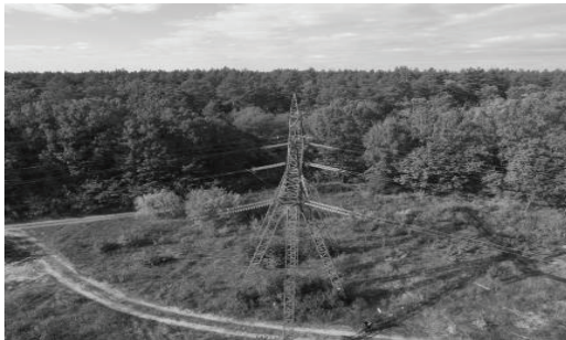
Рис. 6. Ділянка ЛЕП, на якій проводився тепловізійний контроль.
