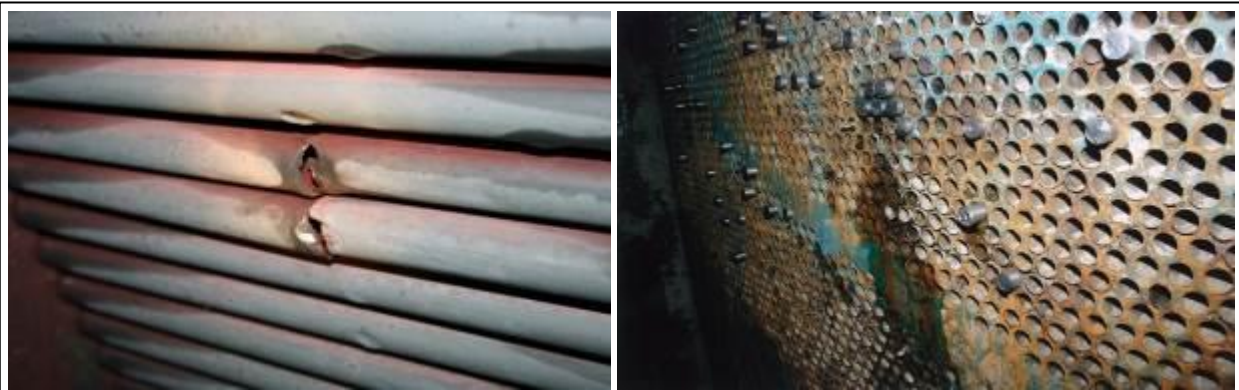
Рис. 1. Дефекты трубных систем в период эксплуатации на конденсаторах АЭС
