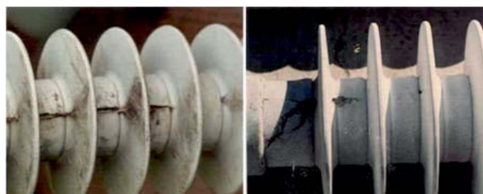
Рис. 16. Наслідки поверхневого пробою полімерного покриття ізолятора
