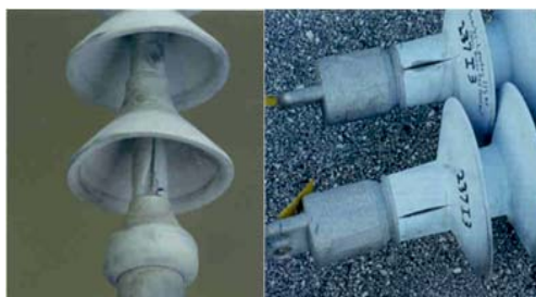
Рис. 14. Поверхневі тріщини з оголенням склопластикового стрижня
