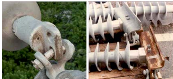
Рис. 8. Корозія на кінцях ізолятора
