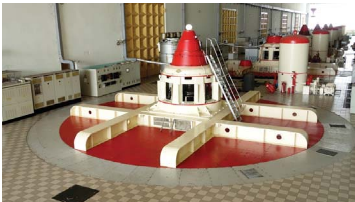
Рис. 3. Машинный зал Каховской ГЭС
