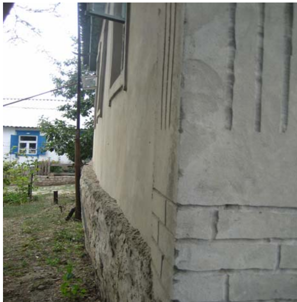
Рис. 2. Посилення цоколю і ремонт стін житлового будинку по пр. Колгоспному, 2 в умовах підтоплення у Краснодарі при відхиленні цоколю і стін від вертикалі до 200 мм
