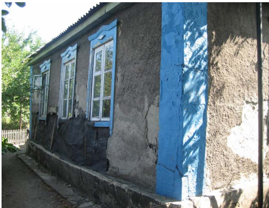
Рис. 3. Ремонт цоколю і стін житлового будинку по пр. Павлова, 3 в умовах підтоплення у Краснодарі при відхиленні стін від вертикалі до 160 мм
