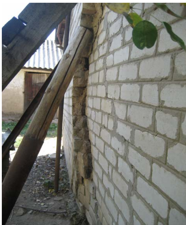
Рис. 4. Тимчасові протиаварійні заходи захисту стіни житлового будинку по вул. Річковій, 13 в умовах підтоплення у Краснодарі при відхиленні оцегловки стіни від вертикалі до 150 мм
