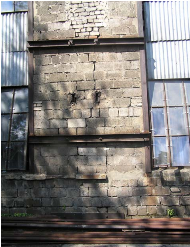
Рис. 4. Деформирование простенков восточной стены станвого пролета прокатного цеха
