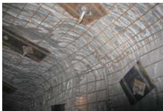
Рисунок 19 – Состояние кровли выработки с анкерной крепью
