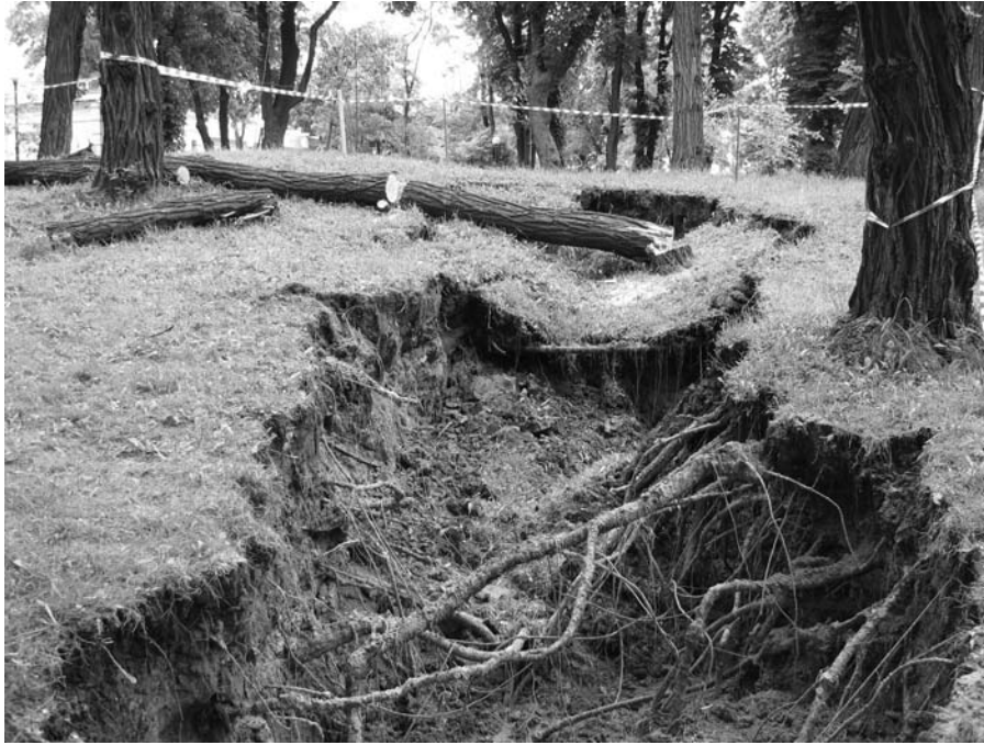
Провал поверхні над дренажною галереєю в Києві на території Міського саду
