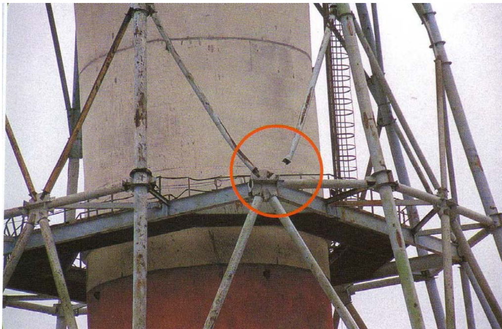
Рис. 23. Дефекты несущего каркаса вентиляционной трубы ВТ-2.
