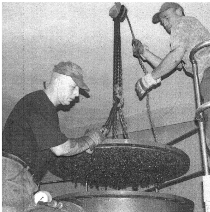
7. Друзы дрейссены на крышке фильтра очистки воды ФВ-4.
