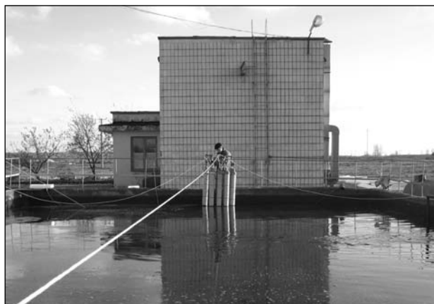
Рис. 4. Розміщення фільтрувального модуля пілотної установки в резервуарі ЦАСО
