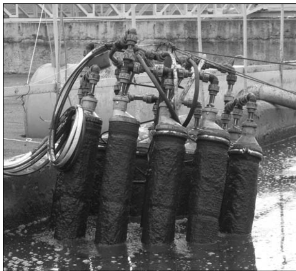
Рис. 6. Фільтрувальний модуль, який підняли на поверхню резервуару ЦАСО після експлуатації без регенерації
