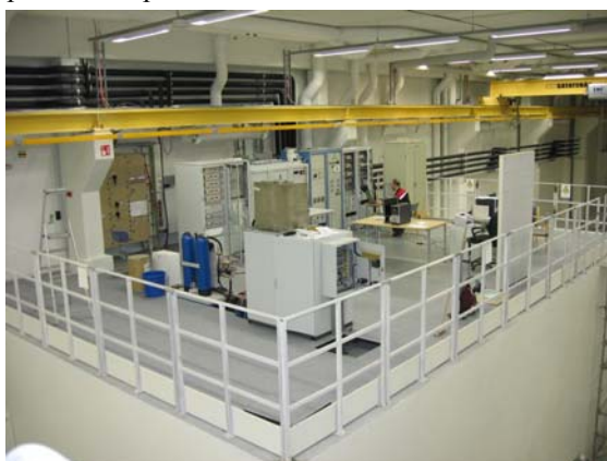
Рис.3. Стойки систем питания и управления циклотрона МСС-30/15 в г. Ювяскюля
