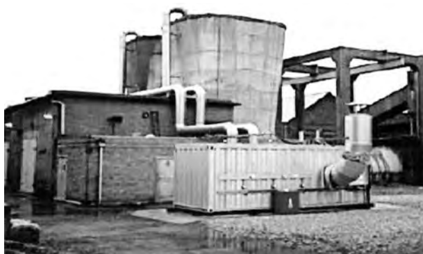
Рис. 4. Комплекс шахтного главного вентилятора и оборудования по окислению метана исходящего воздуха
