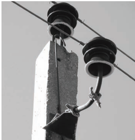
Рис. 2. Лапы орлана-белохвоста, отгоревшие при электрозамыкании, вызванном посадкой птицы на крюк кронштейна опоры ВЛ 10 кВ. (Фото А. В. Салтыкова).
