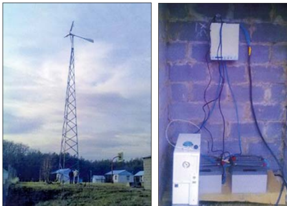
Рис. 3. Вітроенергетична установка, інвертор, акумулятори та генератор водню
