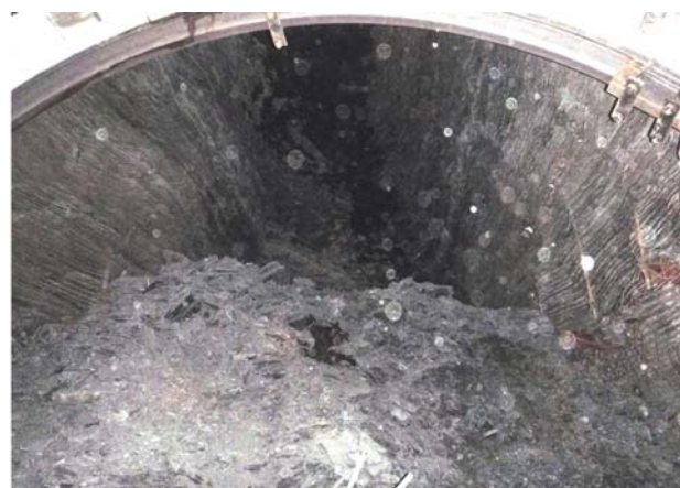
Рисунок 5. Обрушение пород кровли в 163-м сборном штреке шахты “Степная”
