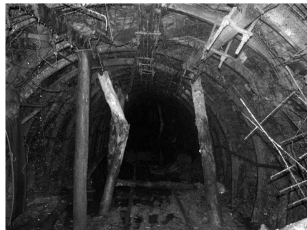
Рис. 3. Состояние дренажного вентиляционного штрека при надработке
