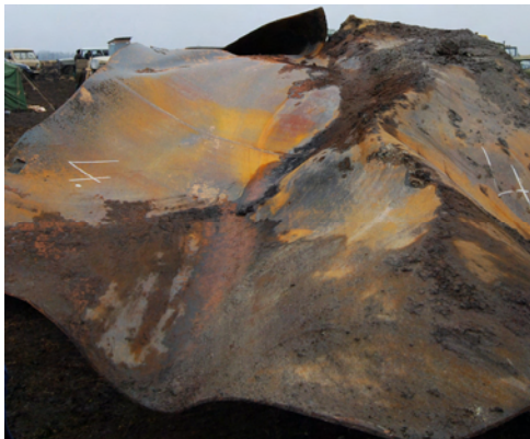
Рис. 1. Руйнування магістрального газопроводу
