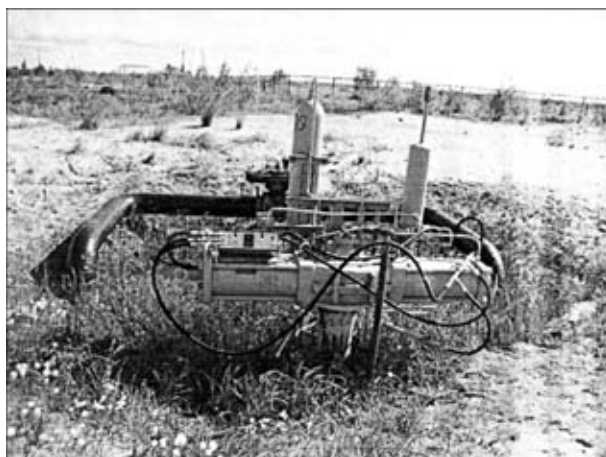
Рис. 2. Испытания системы контроля герметичности затворов ШК на кране Ду 1000 межпромышленного коллектора Уренгойского НГКМ
