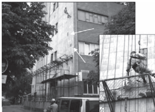
Рис. 6. Дефекты и повреждения (обрушения) плиточной облицовки фасада здания высотой 50 м (а); применение метода промышленного альпинизма при обследовании облицовки фасада (б)
