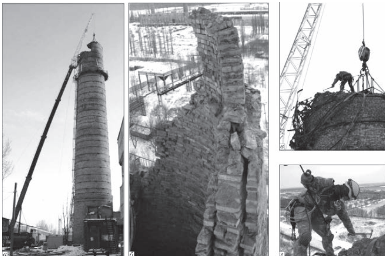
Рис. 2. Аварийное обрушение верхней части кирпичной дымовой трубы высотой 80 м, техническое обследование уцелевших конструкций на отметке +49 м и организация безопасной работы при ликвидации последствий обрушения с помощью стрелового автомобильного крана грузоподъемностью 120 т методом промышленного альпинизма (а); фрагмент дефектного аварийно-опасного участка кирпичной кладки объемом около 15 м 3 на отметке +49 м (б); обследование аварийных участков экспертами-верхолазами (в, г)
