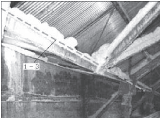
Рис. 4. Сверхнормативный прогиб прогона горизонтальных связей (1-3) составляет 93 мм (обозначен пунктиром)
