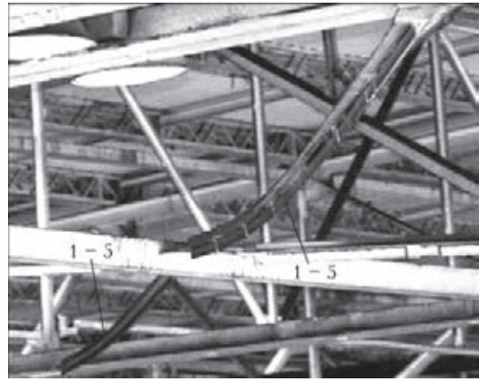
Рис. 6. Механические деформации (погнутости) элементов горизонтальных связей по нижним поясам стропильных ферм покрытия (1-5)
