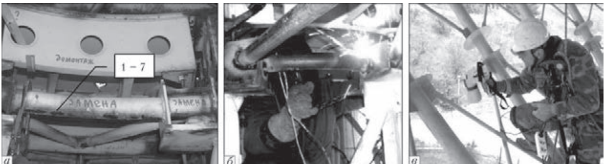
Рис. 11. Ремонтно-восстановительные работы спецоборудования: сквозное коррозионное разрушение стенок полых конструкций (1–7) (а); замена поврежденных элементов (б); нанесение защитного покрытия агрегатами безвоздушного распыления (в)
