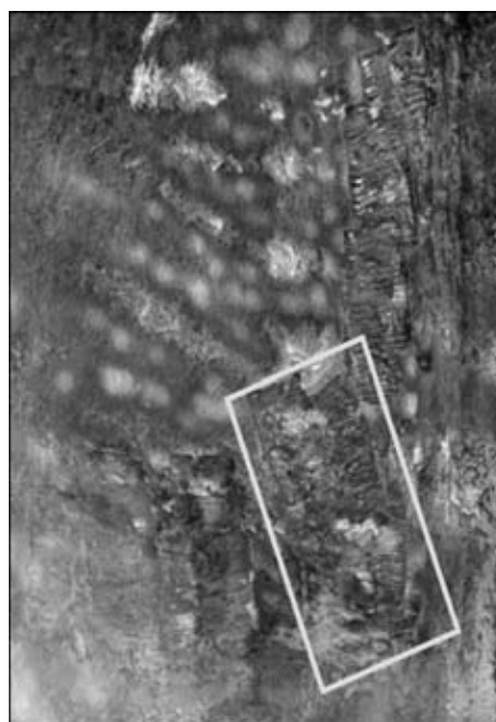
Рис. 9. Устраненные наплавкой дефекты на внутренней стальной оболочке (выделенный участок поверхности, где переварена сеть трещин, показанная на рис. 8)
