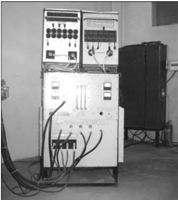
Рис. 4. Источник питания установки TOP-350 для плазменной наплавки плоских изделий с использованием противофазно-импульсного тока
