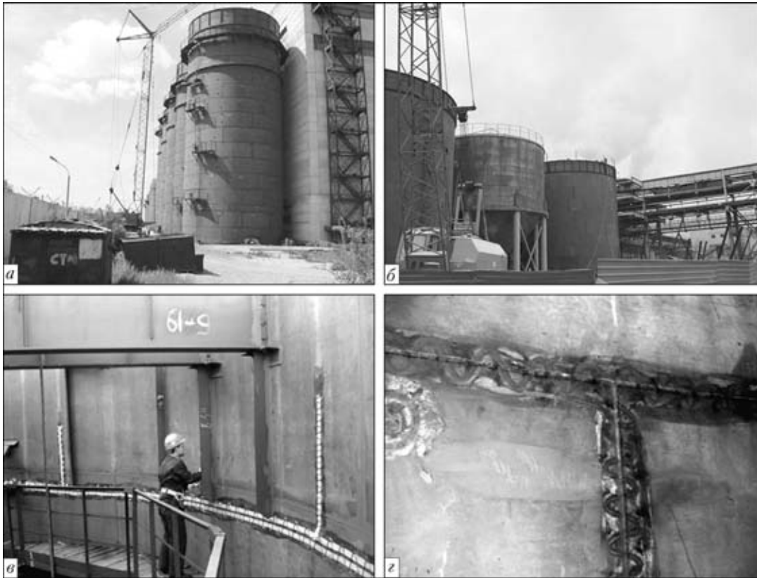
Рис. 1. Внешний вид конструкций, подвергаемых ОВз: а — батарея строящихся декомпозеров; б — технологические баки; в — рабочий момент монтажа зарядов; г — сварные соединения после ОВз
